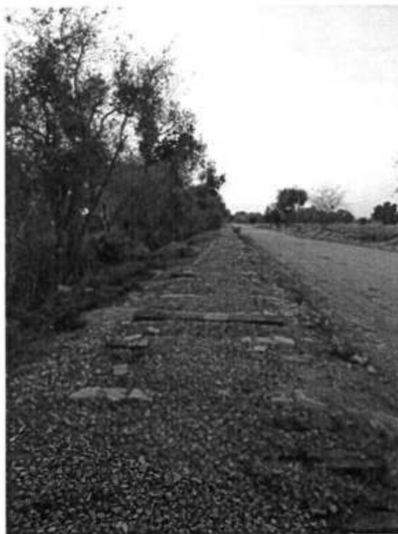
Fotografía 37. ABANDONO Y DESMANTELAMIENTO DE VÍA. Falta de riel y fijación 600 metros vía. Línea VB 77+250. Fuente: Agencia Reguladora del Transporte Ferroviario.
