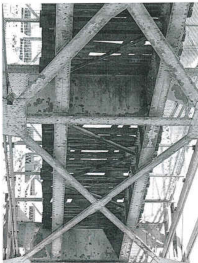
Figura 12. DAÑOS SEVEROS EN INFRAESTRUCTURA (Puente). Todos los elementos de la armadura presentan principios de corrosión por la falta de mantenimiento. Línea R 000+000
