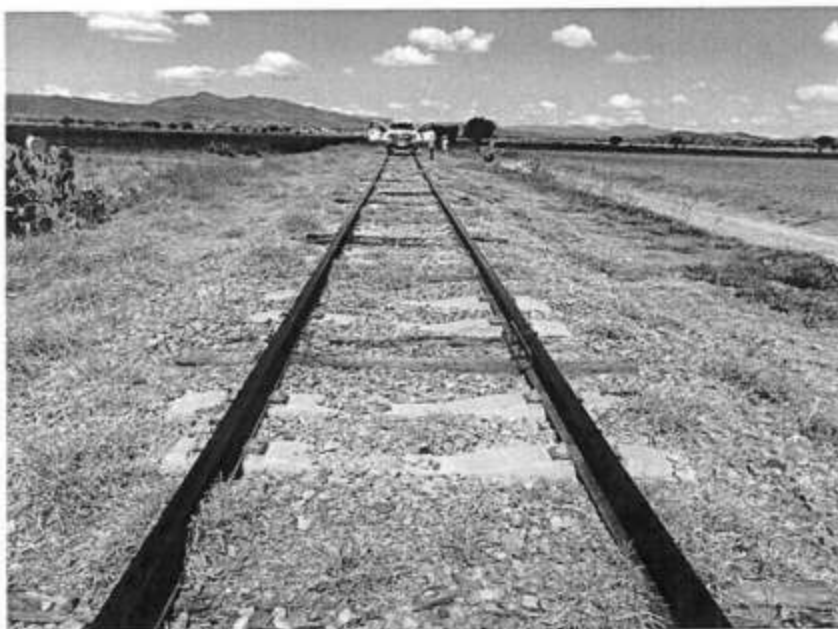
Figura 18. BALASTO ESCASO Y CONTAMINADO. Cantidad de balasto no existente en los hombros y cajones. Línea H 42+300 al 53+500
