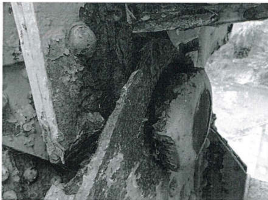
Figura 22. DAÑO EN COMPONENTES. Corrosión en apoyo de estructura, pérdida de material. pila 3. Línea M 420+600.
