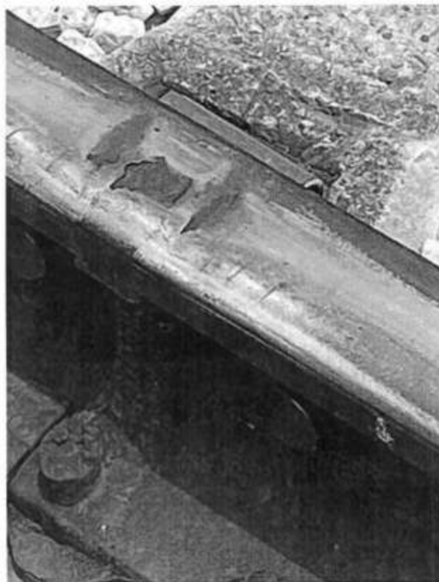
Figura 21. DAÑO EN COMPONENTES. Riel patinado. Línea G 136+785
