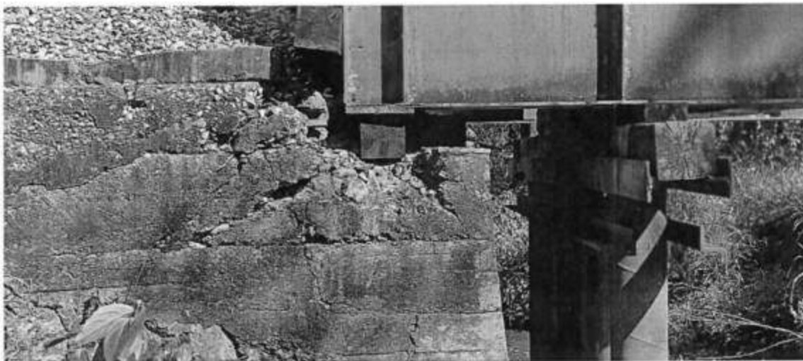
Figura 13. DAÑOS SEVEROS EN INFRAESTRUCTURA (Puente). Estribo fracturado, superestructura apoyada sobre durmientes de madera en estribo y apuntalado, así como principios de corrosión en traves metálicas. Línea Z 78+350
