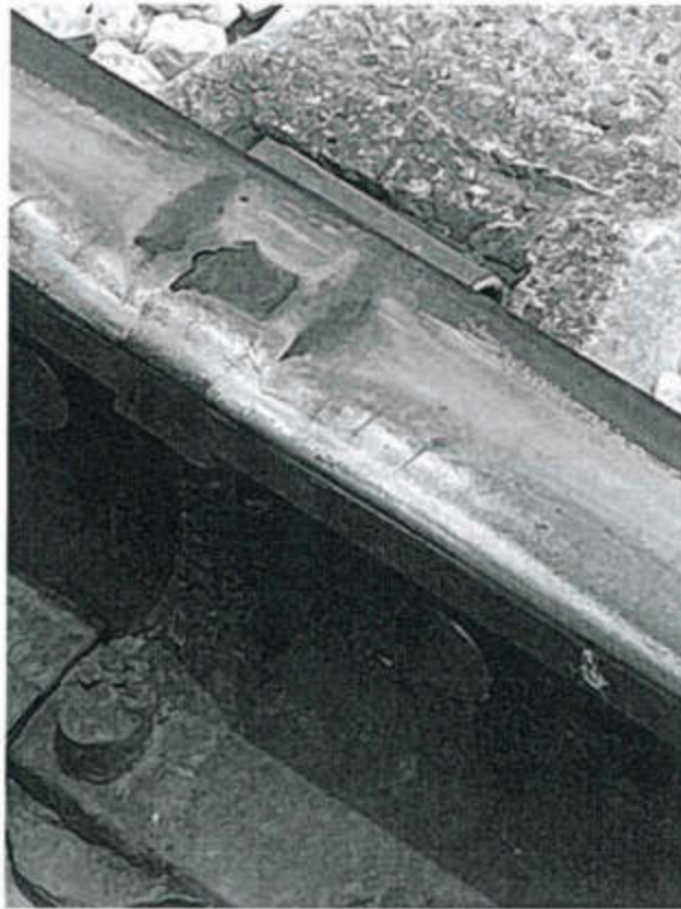
Figura 21. DAÑO EN COMPONENTES. Riel patinado. Línea G 136+785
