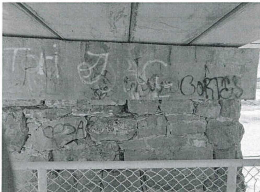
Figura 14. DAÑOS SEVEROS EN INFRAESTRUCTURA (Puente). Cuerpo de pila fracturado con pérdida de junteo, corona fisurada. Línea R 115+560
