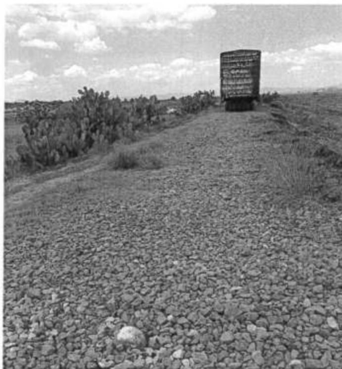
Figura 15. VÍA CONCESIONADA FUERA DE OPERACIÓN. Vía fuera de operación, desde el kilómetro 1+000, no existe la vía. Línea HA 001+000 al 025+037
