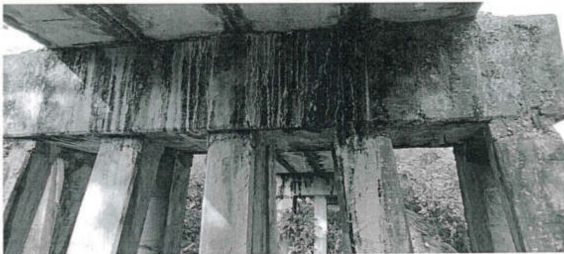
Figura 11. DAÑOS SEVEROS EN INFRAESTRUCTURA (Puente). Concreto en superestructura y subestructura con carbonatación y eflorescencias y acero expuesto con corrosión, así como socavación en pilas. Línea Z 43+560.
