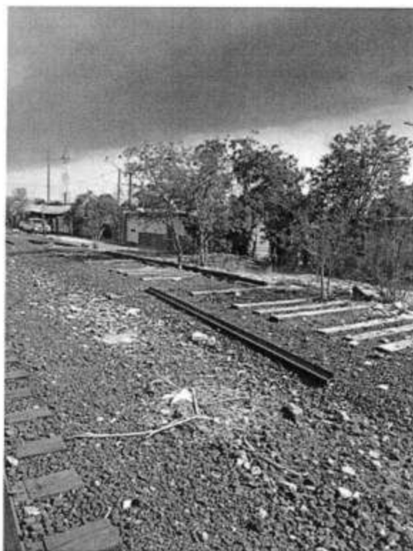
Fotografía 38. ABANDONO Y DESMANTELAMIENTO DE VÍA. Falta de riel y fijación. Línea AJ 0+000
