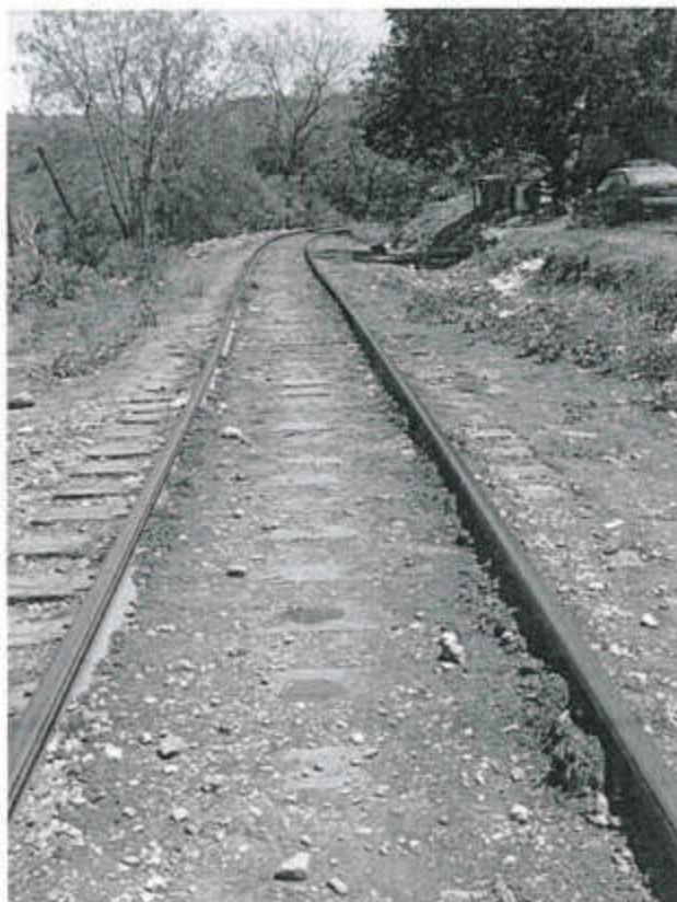
Figura 19. BALASTO ESCASO Y CONTAMINADO. Cantidad de balasto no existente en los hombros y cajones. Línea L 411+867 al 530+334
