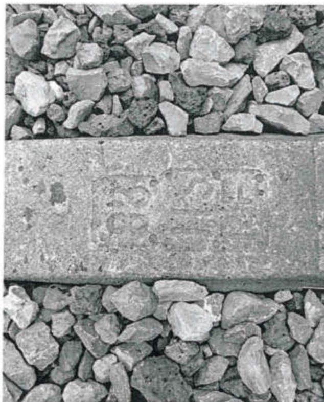
Figura 10. DURMIENTES ANTES DE 1995 (1983). Durmientes ITISA 1983 - 1984, 115 RE. Línea M 408+000 al 483+000
