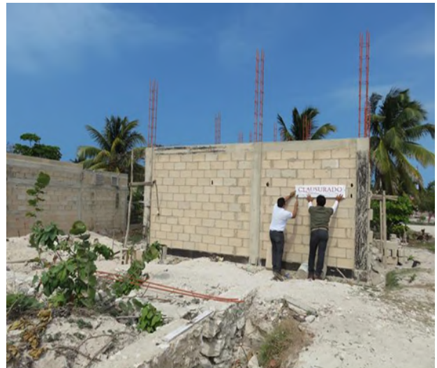
Clausura de obra por no exhibir autorización en materia de impacto ambiental, Rio Lagartos Yucatán
