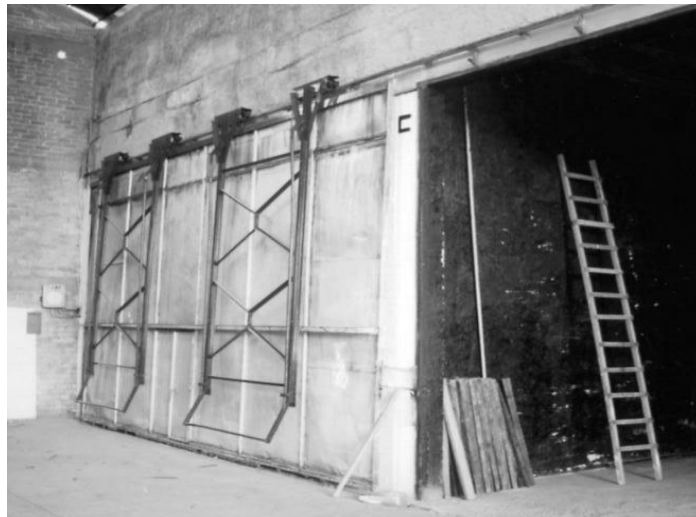
Figura 32. Cámaras de tratamiento, con impermeabilizante en muros interiores y puerta accionada mediante gato mecánico.
