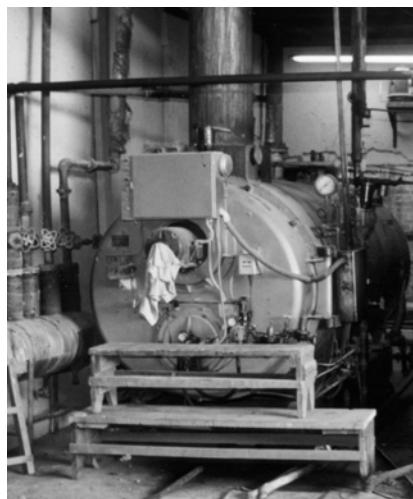
Figura 13. Caldera para vapor mediante quemado de diesel. (Foto: M. Fuentes)
