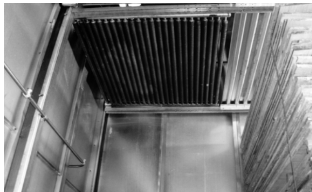
Figura 17. Intercambiadores de calor (tubos aletados) en una cámara de tratamiento térmico y secado de madera. (Foto: M. Fuentes)
