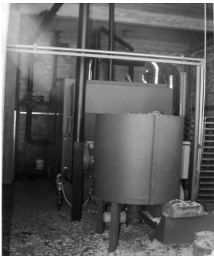
Figura 11. Caldera NARDI® para agua caliente mediante quemado de desperdicios de madera (Foto: M. Fuentes)
