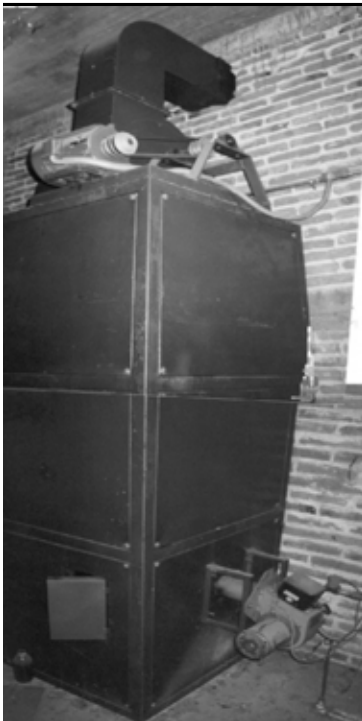
Figuras 12. Equipo de combustión directa de gas LP en una cámara de secado. (Foto: M. Fuentes)
